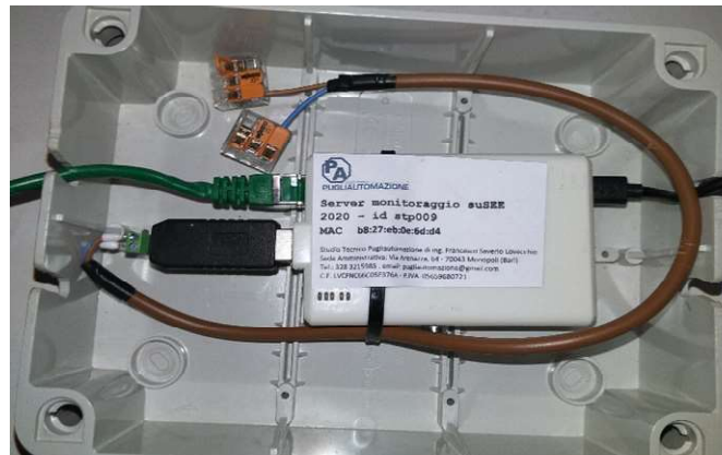
8 Sistema Monitoraggio Energetico - Server
